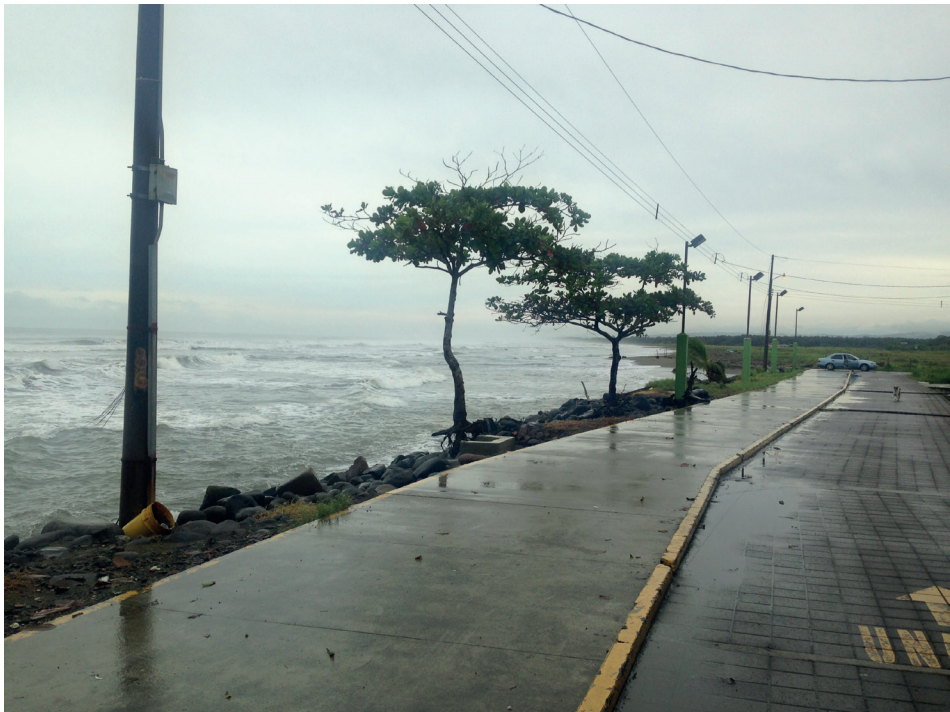
Figura. 4. Colocación de cantos rodados en Playa Cieneguita para proteger la infraestructura pública.
