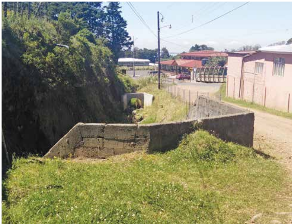
Figura 4. Unión de cauces en calle Montenegro, Fraijanes.
