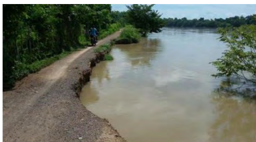
Figura 3. Punto crítico en formación corregimiento de Palo de Agua.
