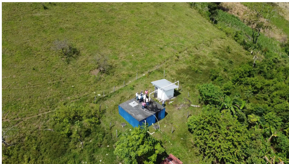
Figura 2. Vista aérea de la estación de filtrado y reservorio de agua del acueducto rural de la comunidad de Platanilla
